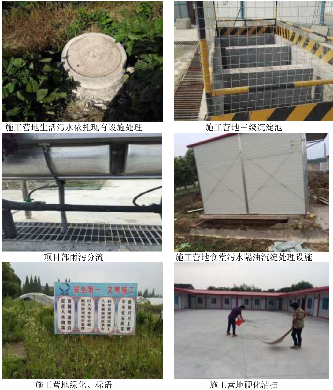
图 5.1-2 施工营地废水处理照片
