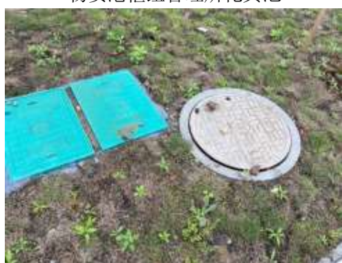
羊尖塘枢纽管理所化粪池
