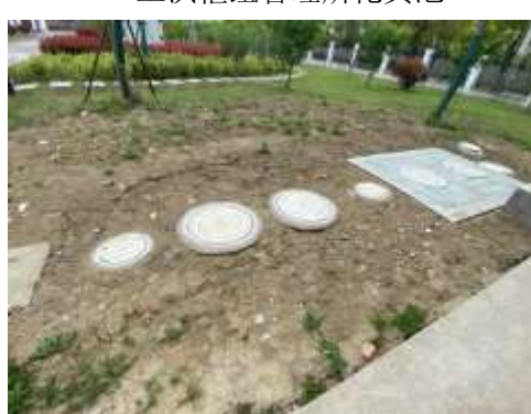
中泾塘套闸管理站化粪池
