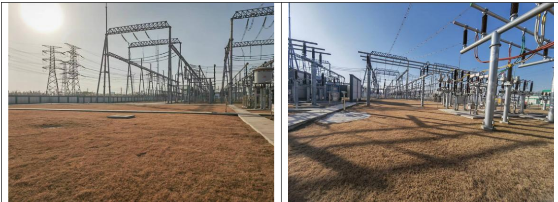
#4主变低压电抗器位置
