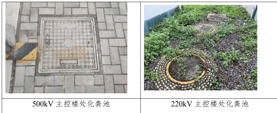
图 3.7 变电站原有化粪池情况
