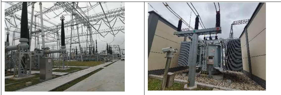
现有 500kV 配电装置 (HGIS)
