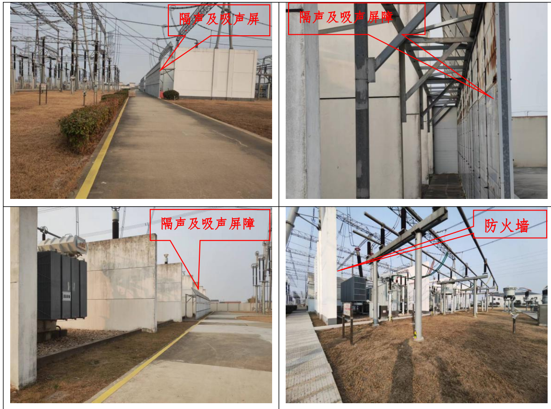
图 3.17 变电站采取噪声控制措施
