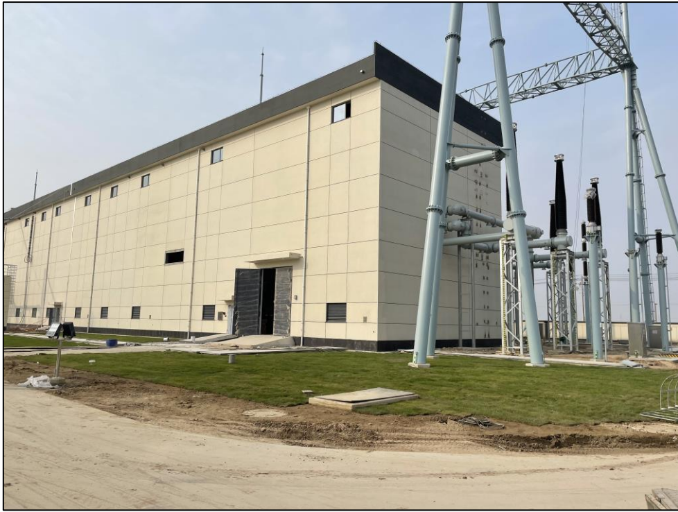
图 3.1-1 500kV 射阳变电站 500 千伏户内型配电装置现状照片
