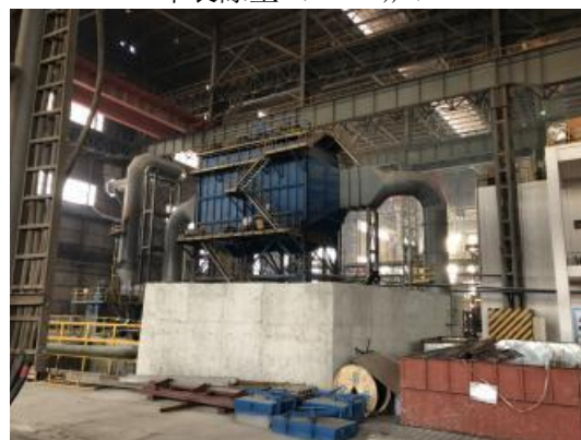
火焰切割湿电除尘器
