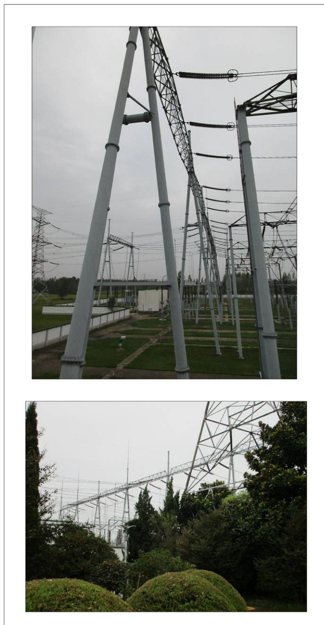
图 3.9 三堡 500kV 变电站扩建端情况
