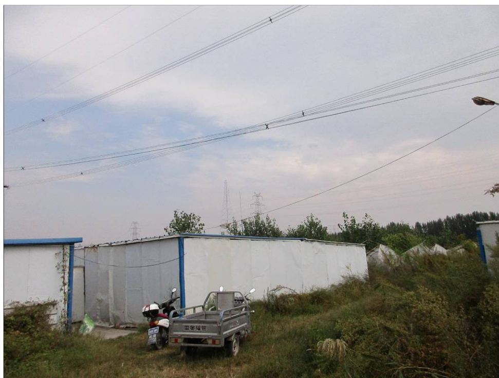
图3.6 任庄500kV变电站扩建端情况
