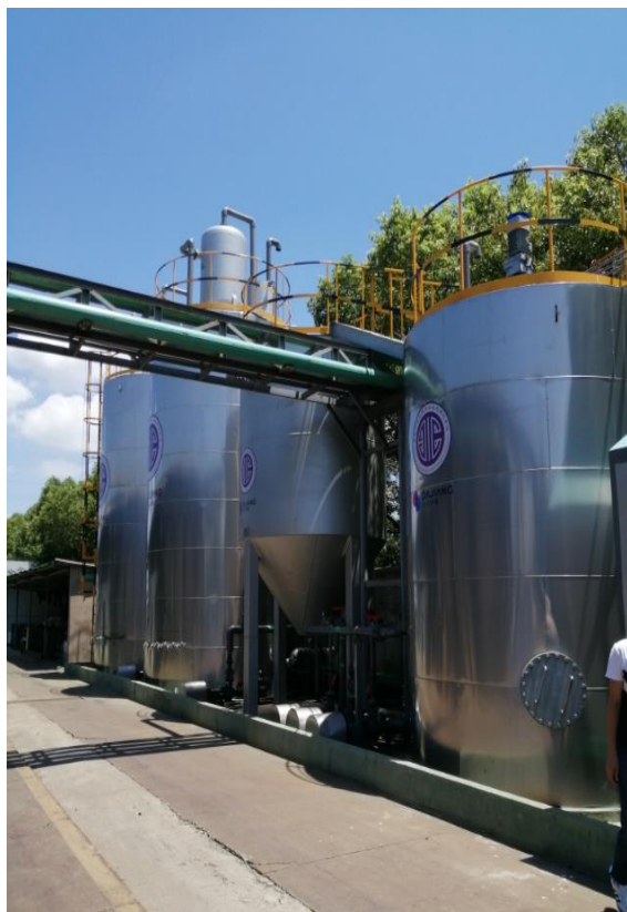
从左往右依次为：脱氮反应器（2座）、沉淀池、调节罐
