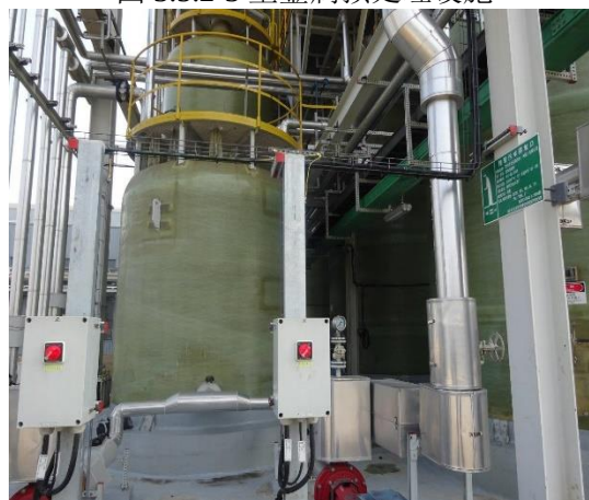
图 3.5.2-5 污水处理站总排口
