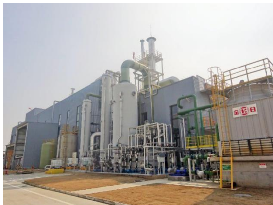
图 3.5.1-2 酸性和碱性废气废气处理设施
