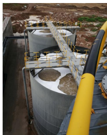
接触氧化单元、二沉池
