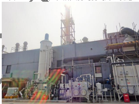
图 3.5.1-4 有机废气废气处理设施
