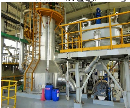
图 3.5.2-4 MVR 蒸发设备
