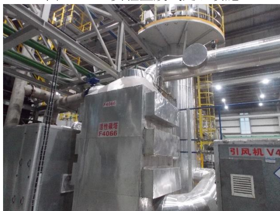
图 3.5.1-3 焚烧炉尾气处理活性炭设施
