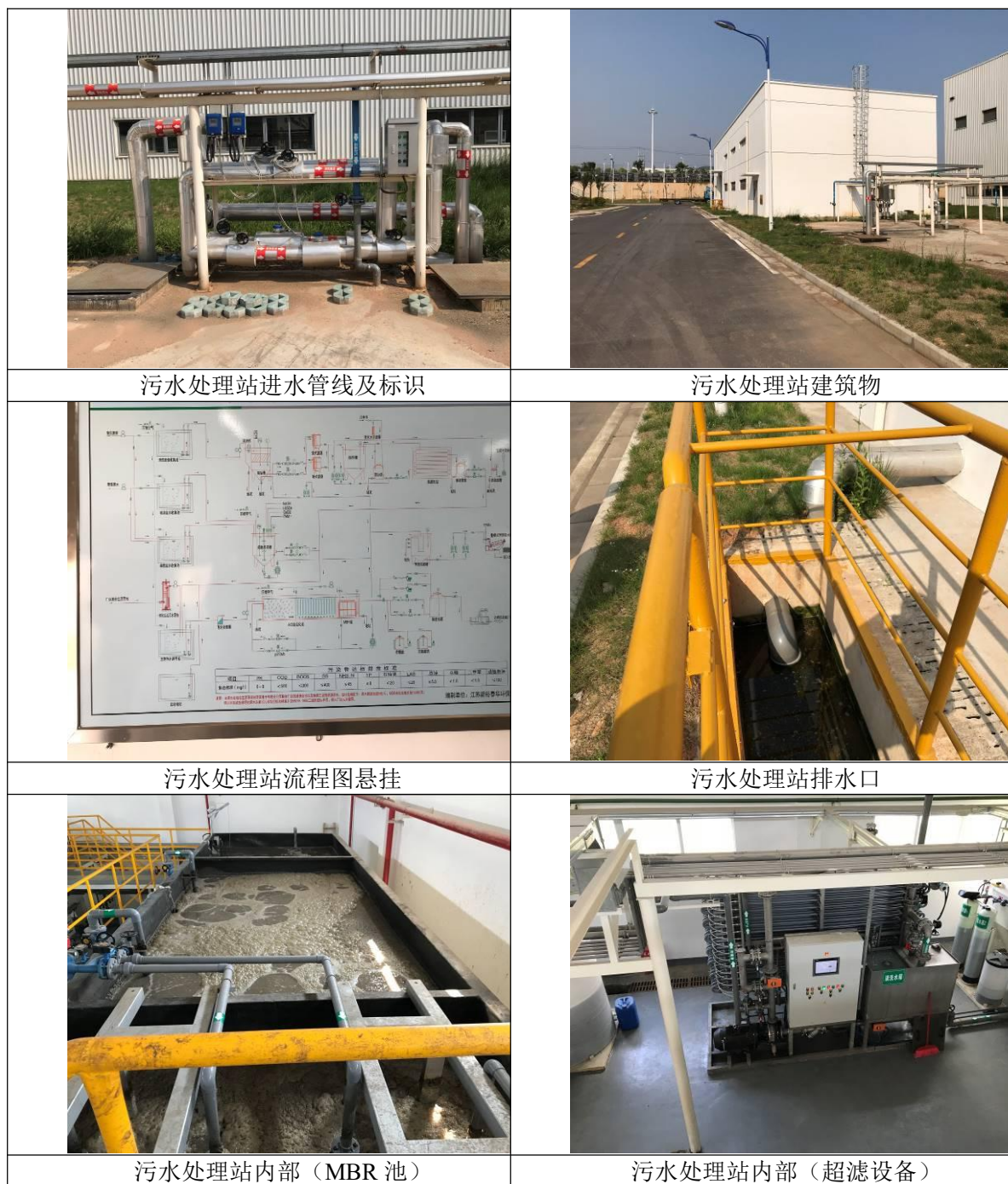
图 3.7-4 废水处理措施照片
