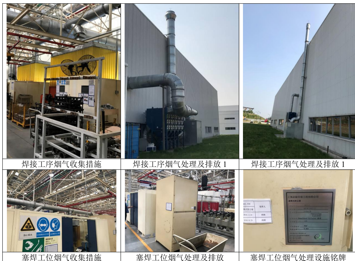
图 3.7-12 焊接烟尘收集、处理设施现场照片
