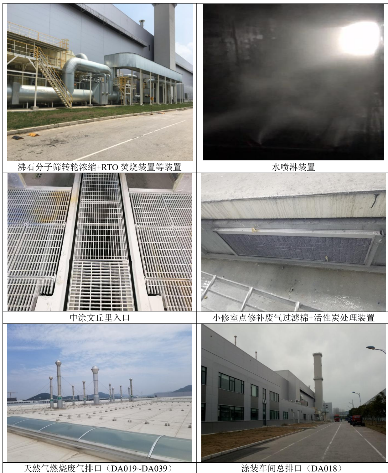
图 3.7-8 涂装车间废气污染防治措施现场照片
