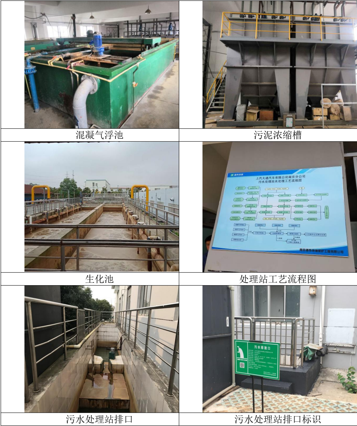
图 3.7-2 综合污水处理站照片
