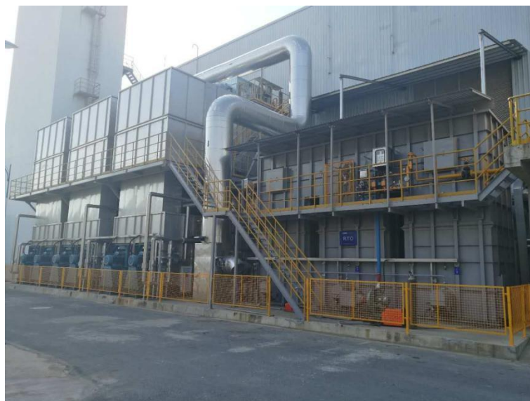
图 7.1-2 现有车身涂装车间转轮浓缩+RTO 焚烧装置现场
