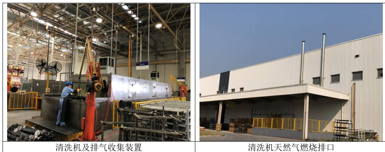
图 3.7-16 天然气燃烧装置现场照片
