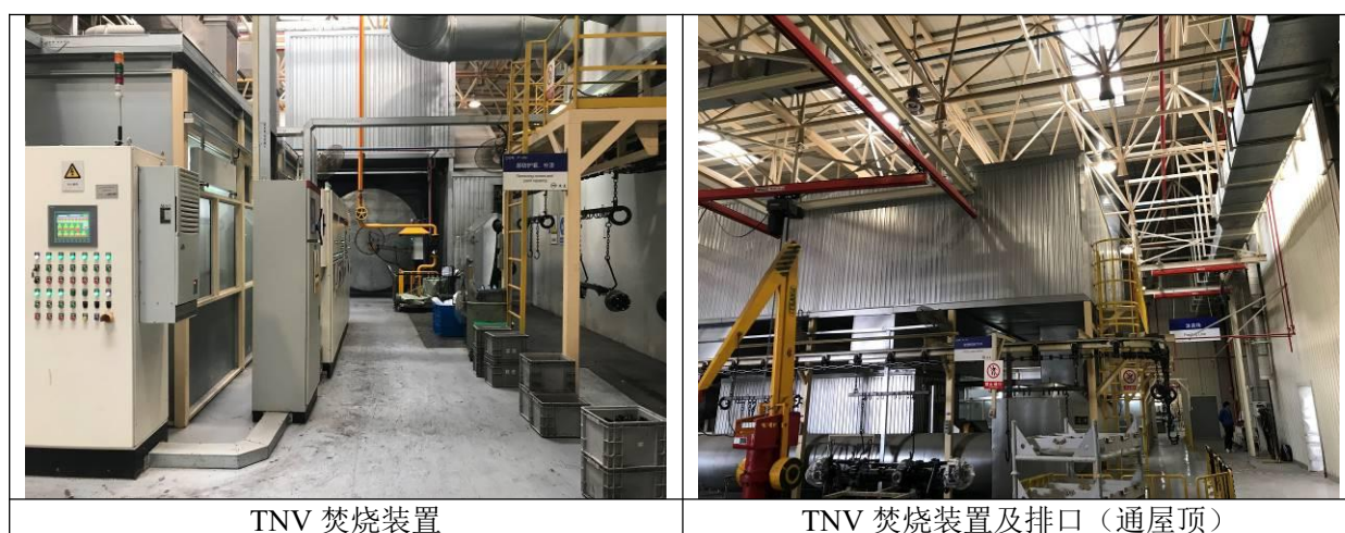
图 3.7-15 烘干室 TNV 焚烧装置现场照片
